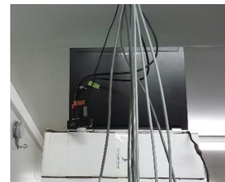
Figure 5: PC surélevé pour être à proximité du toit de l'Algeco sur lequel sont situés les micro-capteurs faute d'une longueur de câble suffisante (câbles spécifiques nécessaires).
