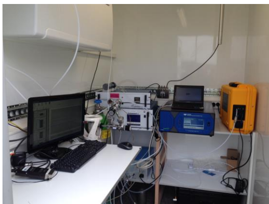
Figure 8 : Photographie des équipements installés dans l'une des 2 cabines du site du CNPP
