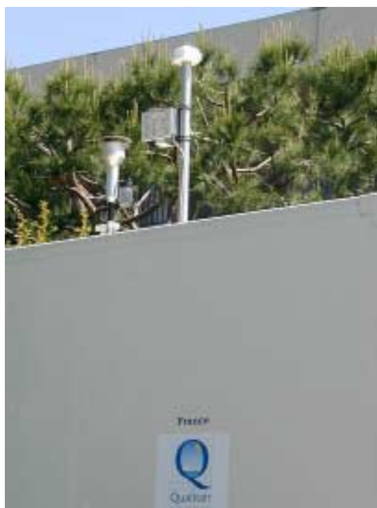
Photo 2 : installation à Cagnes sur Mer (Qualitair 06)
