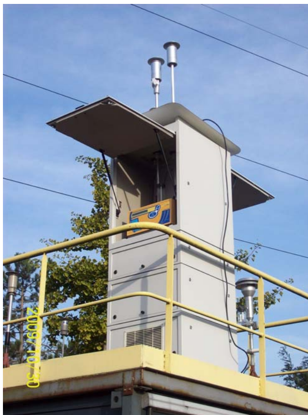
Figure 8 : Vue générale du FAI Hydra Dual Sampler
