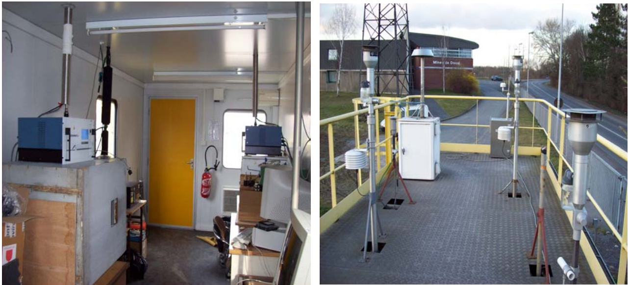
Figure 2: Jauges MP101M-RST PM 2.5 sur le site de mesure de l'EMD (intérieur & extérieur)
