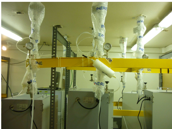
Figure 1 : intérieur de la station de mesure.
