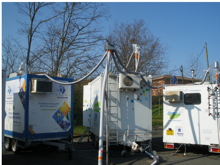
Figure 36 : Vue du diffuseur sur son mât télescopique et des 3 têtes de prélèvement coiffées.
