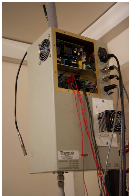
Figure 7 : Câblage sur la carte électronique du FDMS pour l'acquisition sur station
