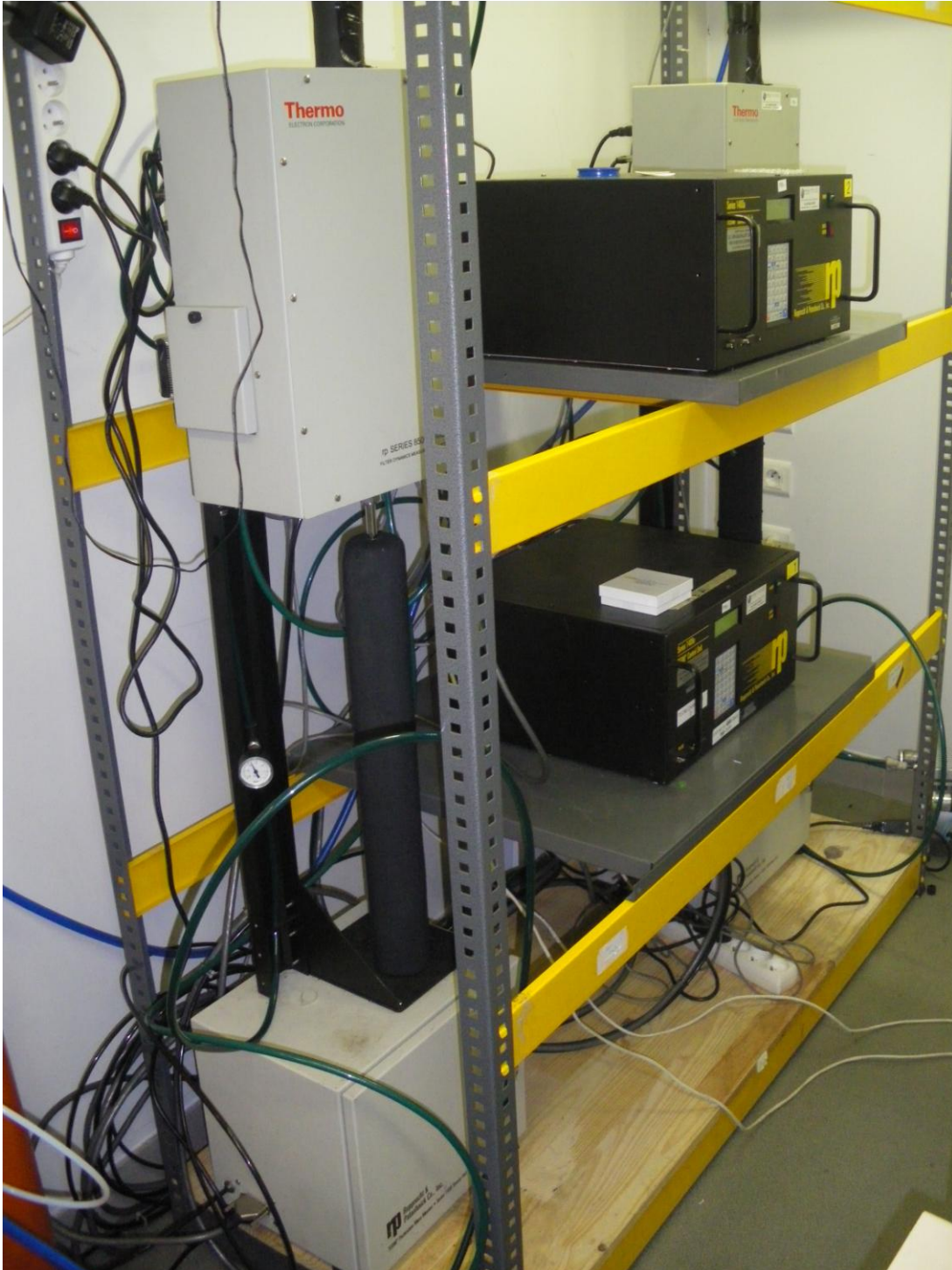
Figure 5 : Vue de l'intérieur de la station, analyseurs AEAT avec module FDMS type C (à gauche) et type B (à droite)
