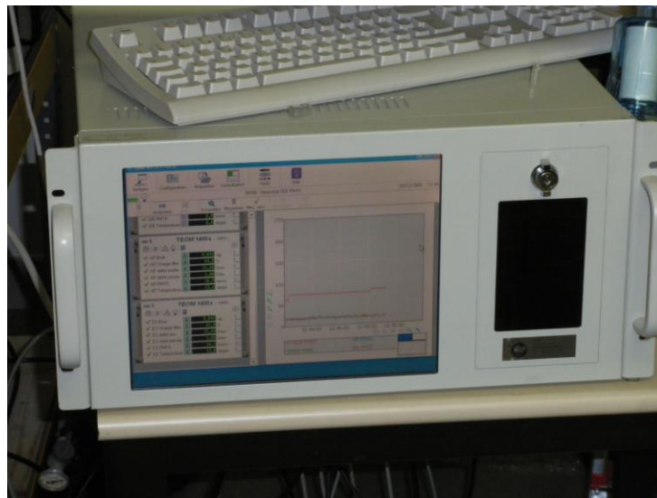
Figure 7 : Vue de la centrale d'acquisition
