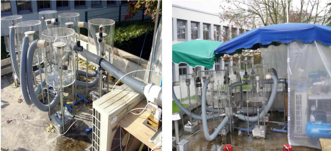
Figure 8 : Vues générales de l'installation en toiture
