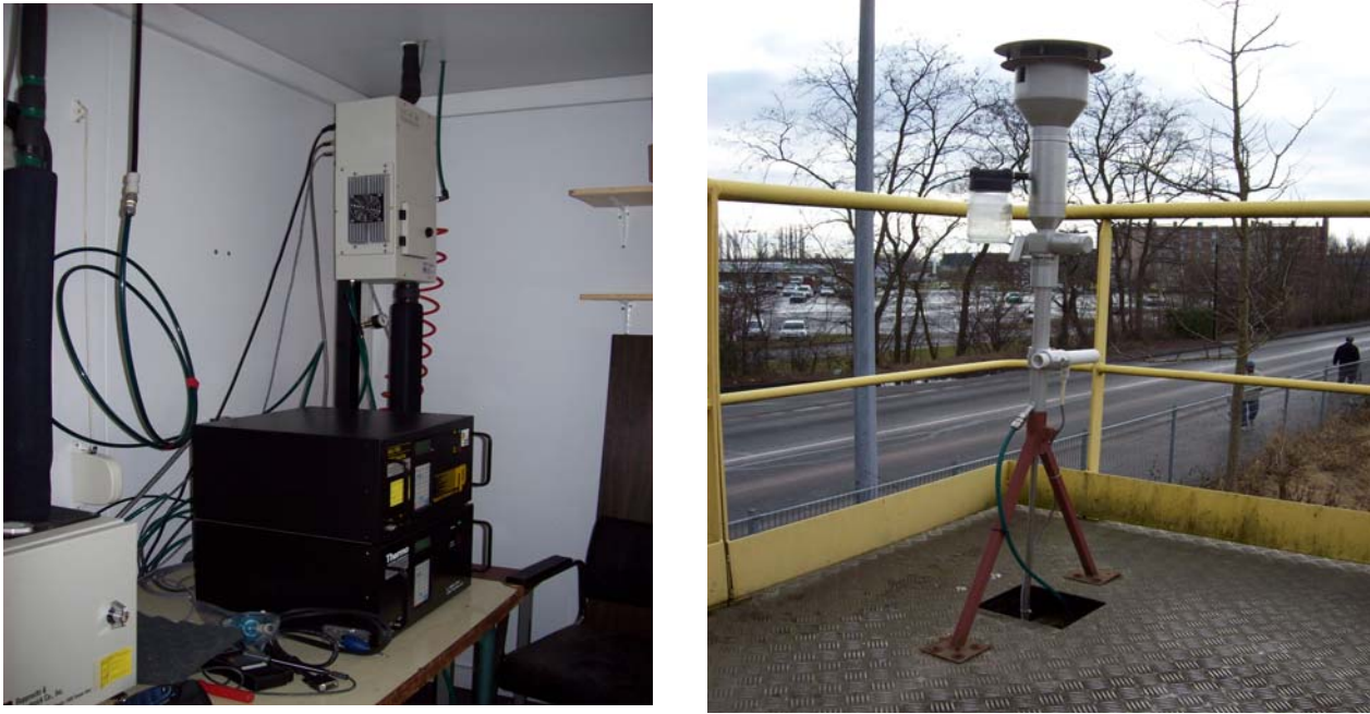
Figure 3: L'appareil Thermo R&P FDMS PM 2,5 sur le site de mesure de l'EMD (intérieur & extérieur)
