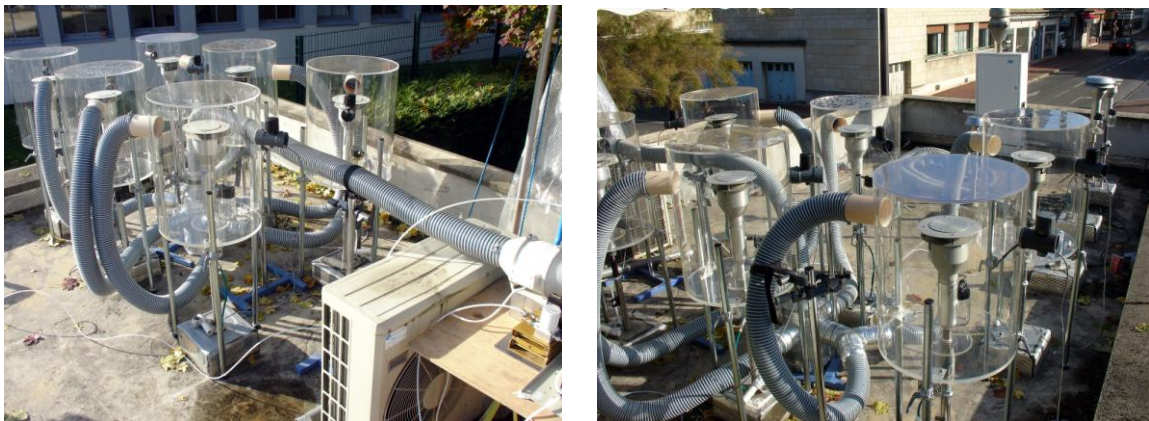
Figure 5 : Vues générales de l'installation en toiture
