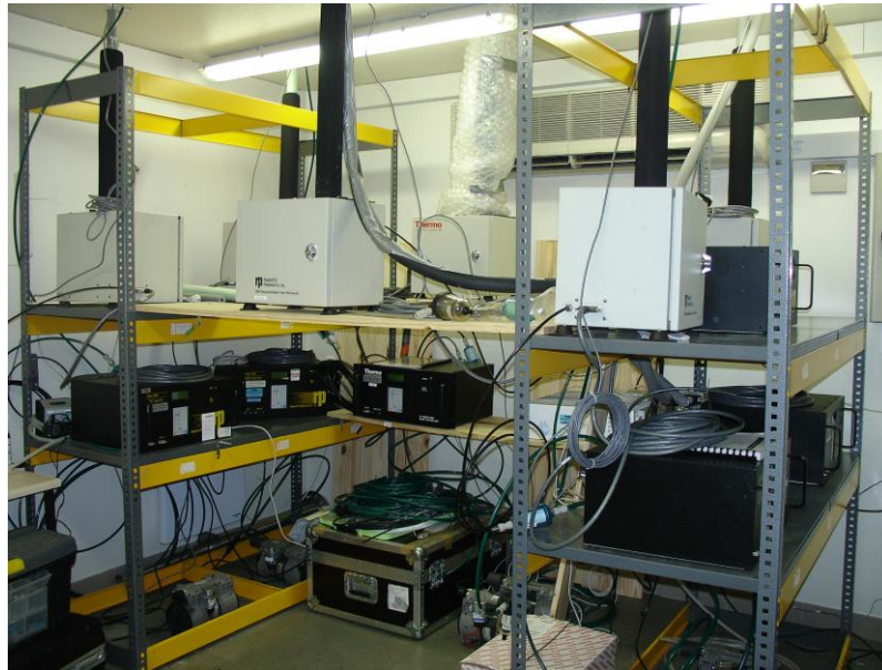
Figure 6 : Vue générale de l'intérieur de la station
