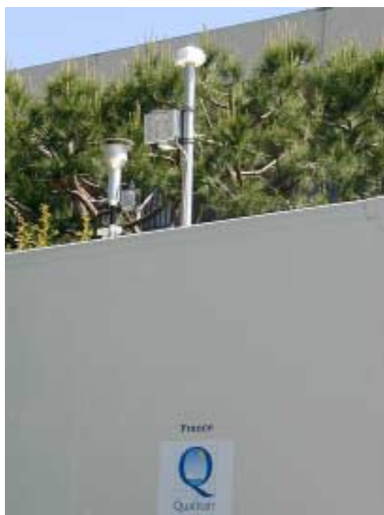
Photo 2 : installation à Cagnes sur Mer (Qualitair 06)
