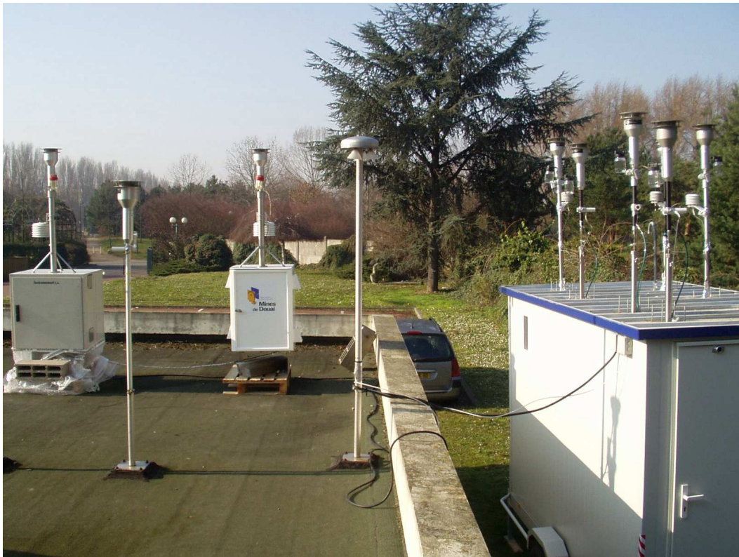
Photo 4.a : photo d'ensemble de l'installation.
