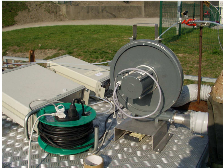
Photo 3.4 : A gauche du ventilateur : générateur d'ozone « haute concentration ».
