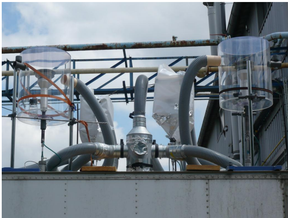
Figure 4 : Dispositif de distribution, sur le toit de la station mobile INERIS (vue n°2).
