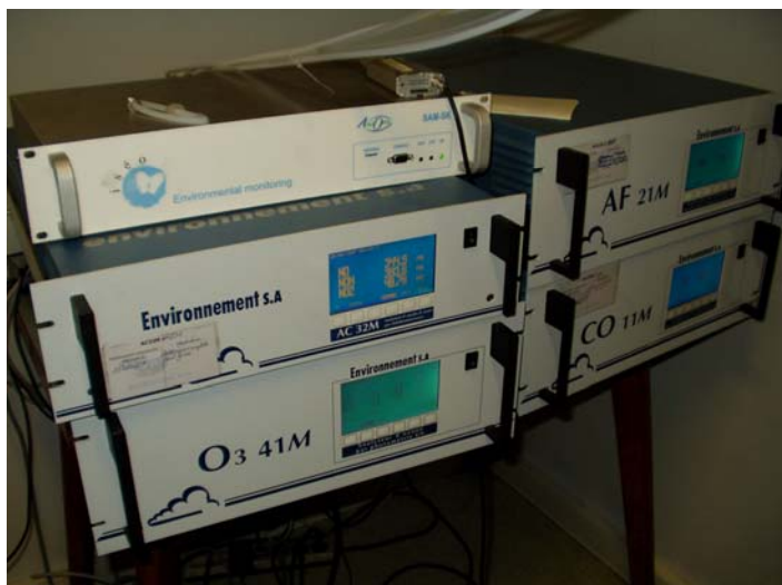
Figure 4 : Analyseurs en doublons installés dans la station Champforgeuil
