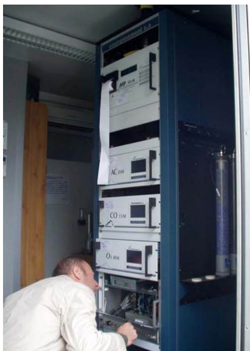
Figure 3 : baie d'analyseurs titulaires installés dans la station Champforgeuil
